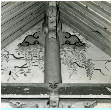
改修前の本殿側面の妻組の藤
