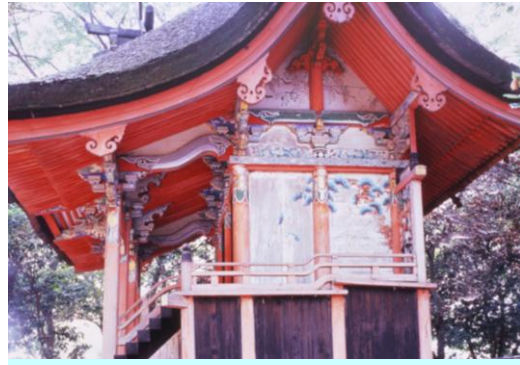
改修前の奈加美神社本殿側面
